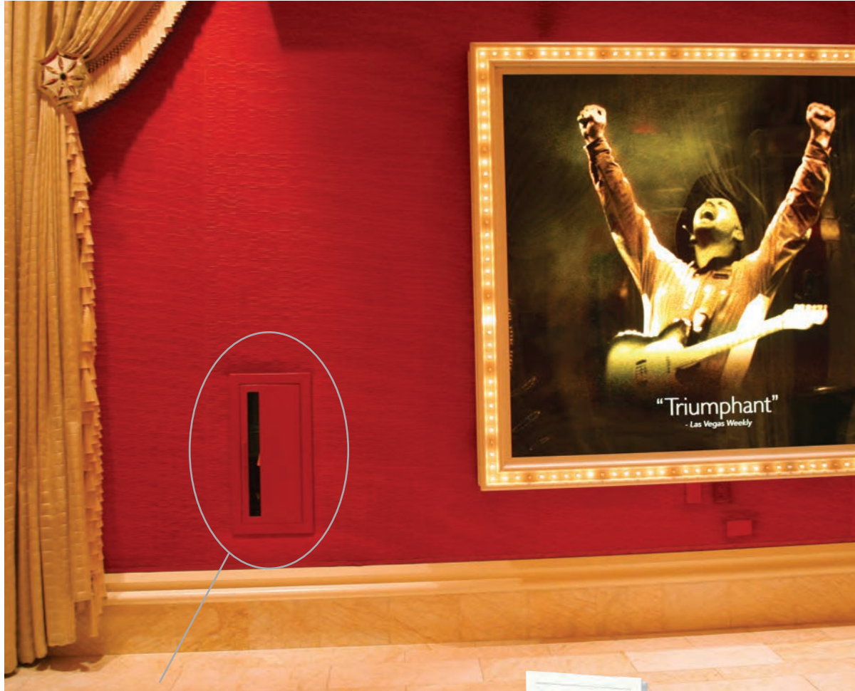
Puesto fijo de acero semiempotrado para extintor
