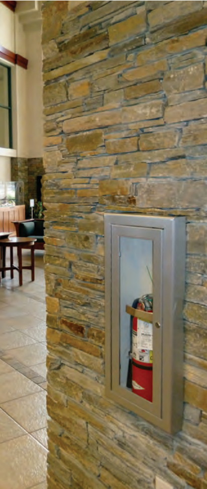
Puesto fijo semiempotrado para extintor
