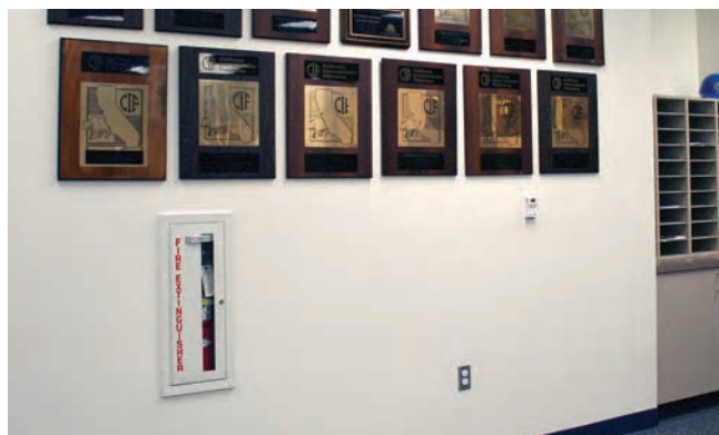
Armario para extintor Potter Roemer® utilizado en el gimnasio de una escuela
