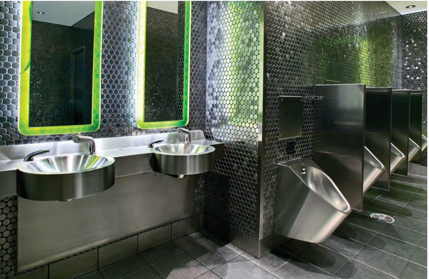
La decoración de baños de Neo-Metro combina un atractivo aspecto actual con la durabilidad del acero inoxidable
