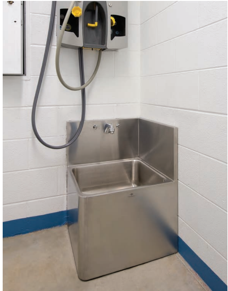
Los fregaderos para fregonas de acero inoxidable ofrecen puestos de desinfección y limpieza de fácil mantenimiento.
