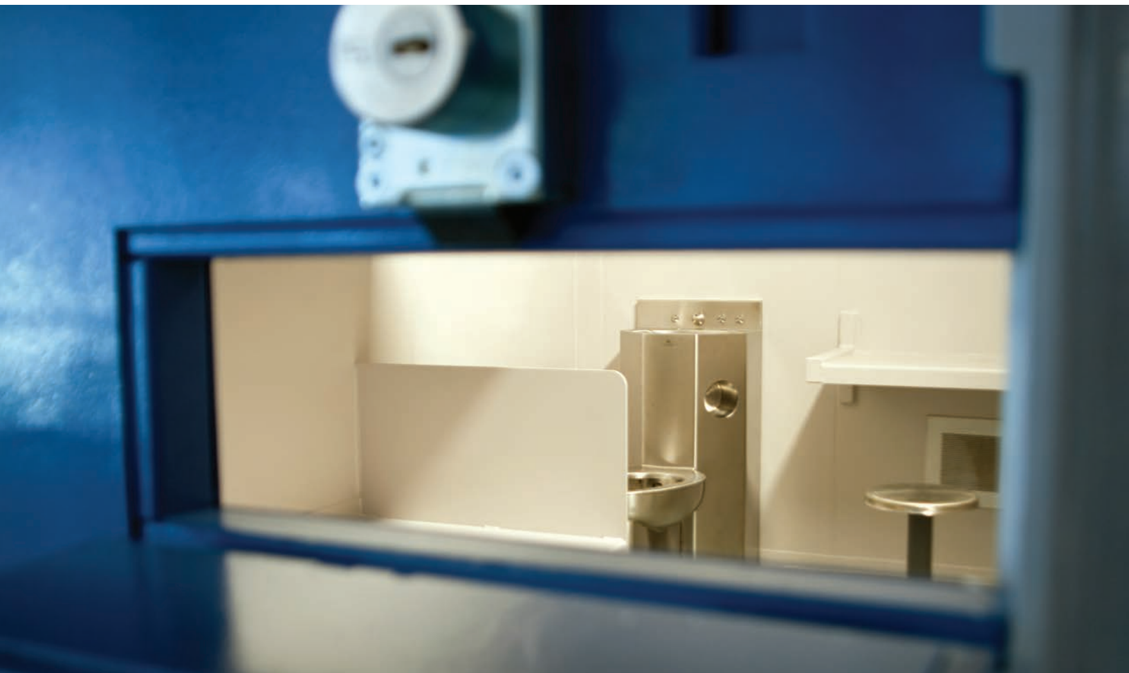
Lavabo-inodoro "Comby" de acero inoxidable instalado en una celda
